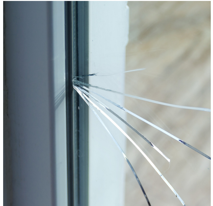
Der rechtwinklige Verlauf des Einlaufs von der Glaskante ist charakteristisch für ein Bruchbild aufgrund thermischer Belastung.
